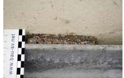
Abb. 1.10: Die Ursache für die Rissbildung in Abb. 1.9 ist eine punktförmige Auflagerung der Balkonplatte anstelle einer linienförmigen Auflagerung gemäß der zugehörigen Zulassung.
