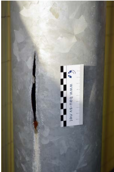
Abb. 1.8: Durch Wasser und Frosteinwirkung geplatzte Rundstahlstütze
