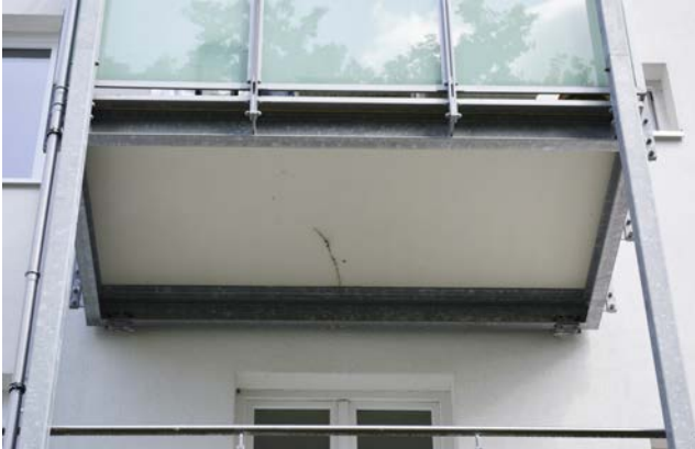
Abb. 1.9: Mittige Rissbildung auf der Unterseite einer Balkonplatte aus Polymerbeton
