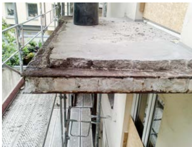
Abb. 1.6: Seitenansicht einer alten Balkonkonstruktion aus Stahlträgern und Füllbeton: Die Stahlträger wurden im Rahmen einer Sanierung freigelegt. Der Beton zwischen den Trägern (Kappenbeton) ist noch tragfähig und bleibt erhalten.
